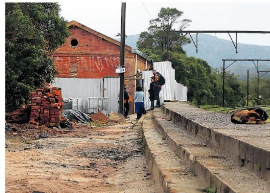
IMPORTANTE. Trabalho de restauro da Estação Ferroviária de Campo Grande anima comunidade
